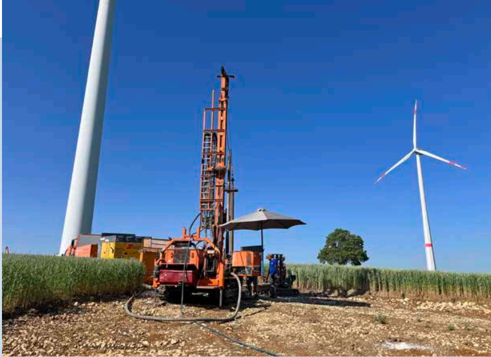
Im August rückten die Maschinen für die ersten Fundamentarbeiten und den Wegebau an.
